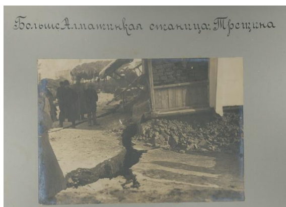
Рисунок 3. КП 15922/25 – Большая Алматинская станция: трещина.
